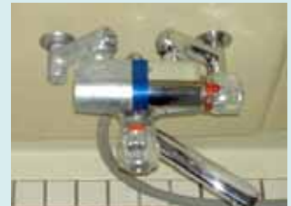
右側部分のみ洗浄した写真
